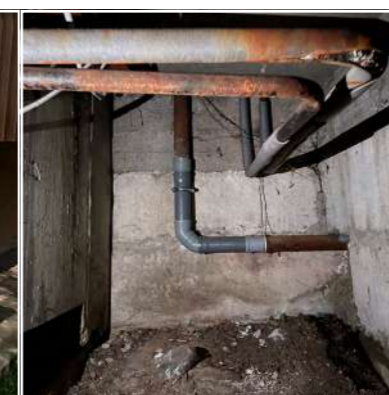
Через укриття проходять труби
