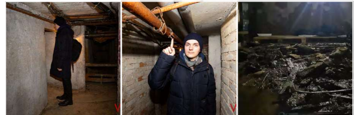
Низько розміщені труби
